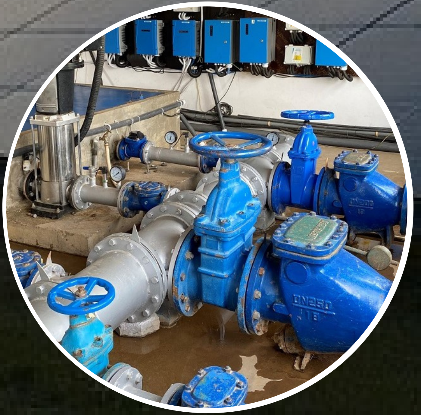
BOMBEO SOLAR PARA INDUSTRIA
